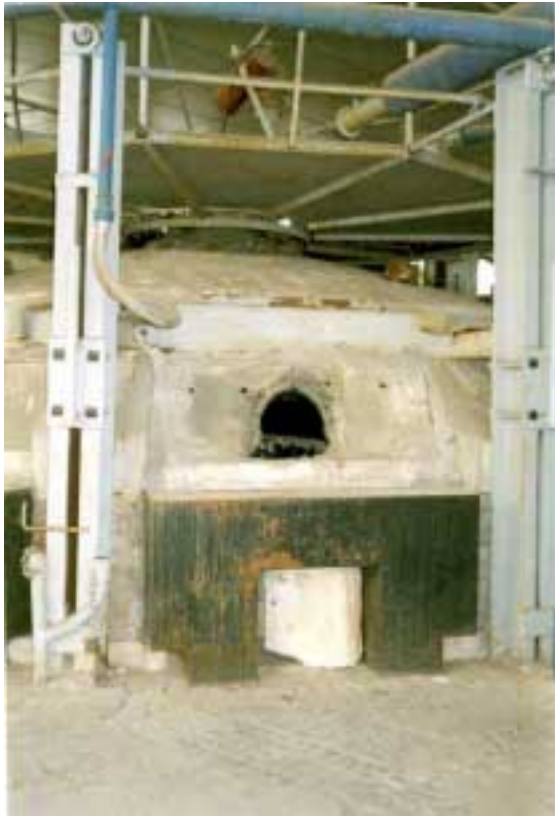
Abb. 2002-1/213 Glasfabrik Vallerýsthal 2001, Glasofen Sammlung Valsar
